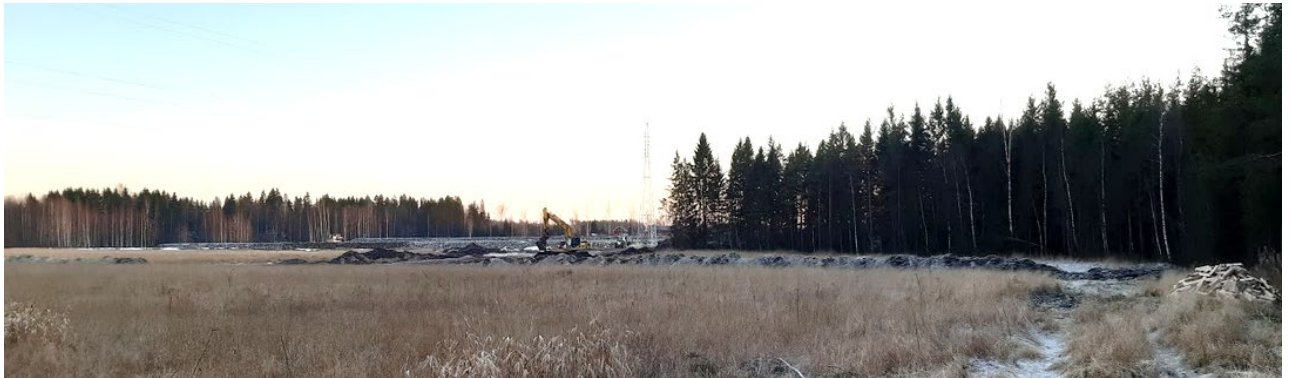
Kuva 6. Näkymä kaavasunnittelualan eteläreunalta kohti etelää. Taustalla näkyy logistiikka-alueen rakentamistyöt. Rautatie- ja maantietermiinaali on valmistunut.
