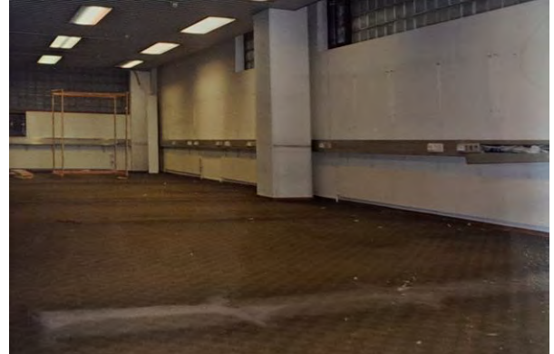
Kuva 68. Kuvassa huonokuntoinen kirjaston alkuperäinen kokolattiamatto. Kuva vuodelta 1993.
