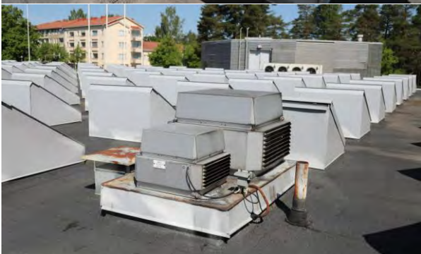
Kuva 128. Kuvia kirjaston katolta, ikkunoista ja asennuksista.
