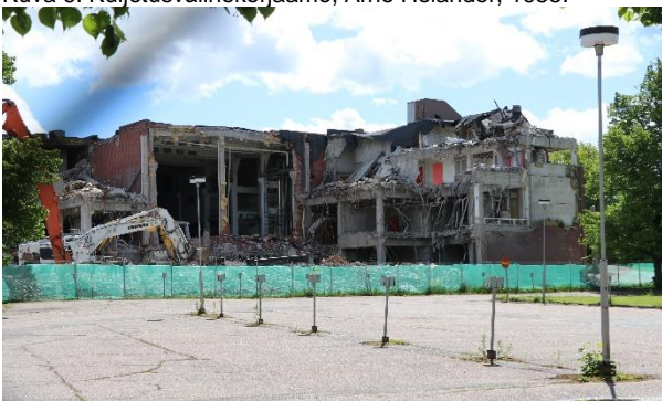
Kuva 7. Päällystyslaitos on purettu vuonna 2022.
